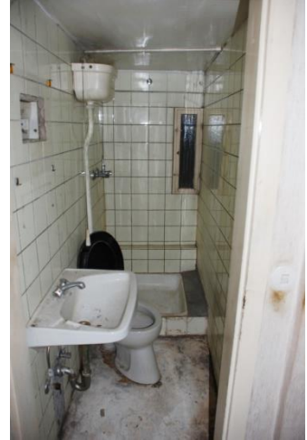
(22) OG Sanitäre Anlagen
