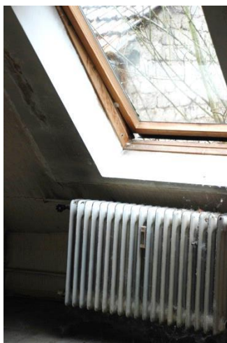
(27) DG / Fenster offen Wasser dringt in die Bau- substanz ein
